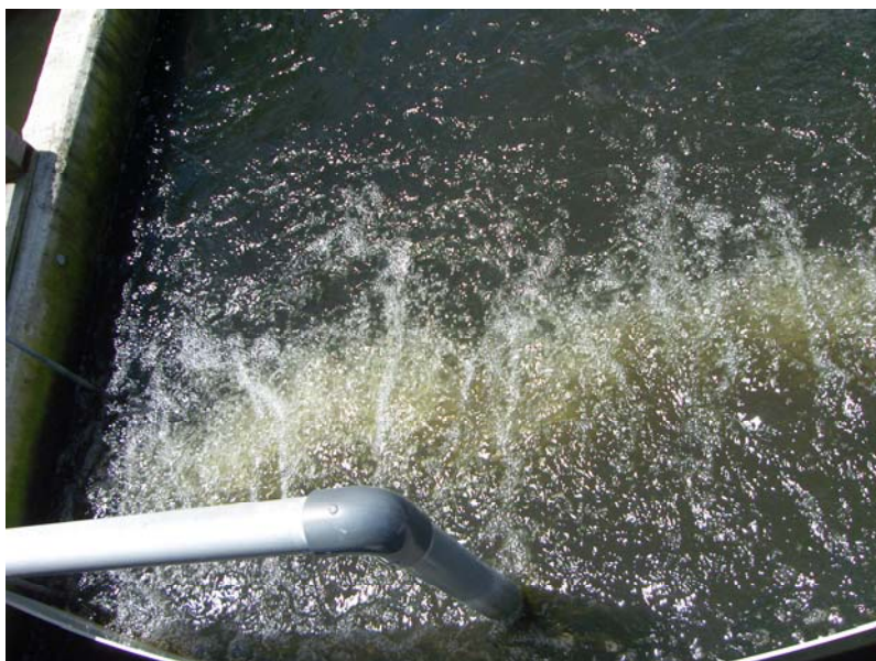
Obr. 7.: Detail na airlift umístěný na odtokové části odchovného žlabu.
