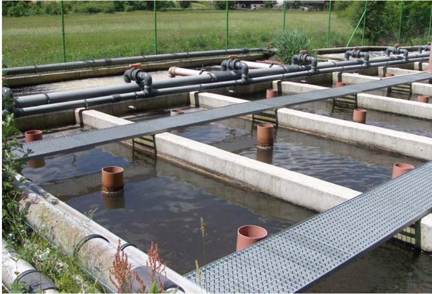
Obr. 4.: Pohled na sekce ponořeného biofiltru.
