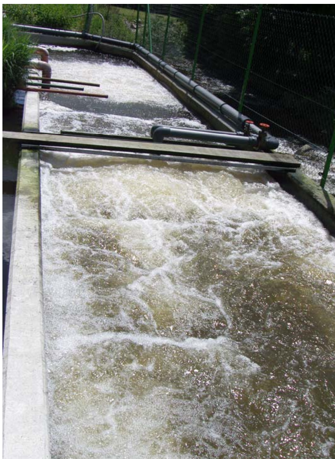
Obr. 2.: Pohled na provzdušňovací a odplyňovací rošt (vzadu) a na tzv. „hluboký airlift“ (uprostřed) , který je hnacím motorem vody v recirkulačním systému.
