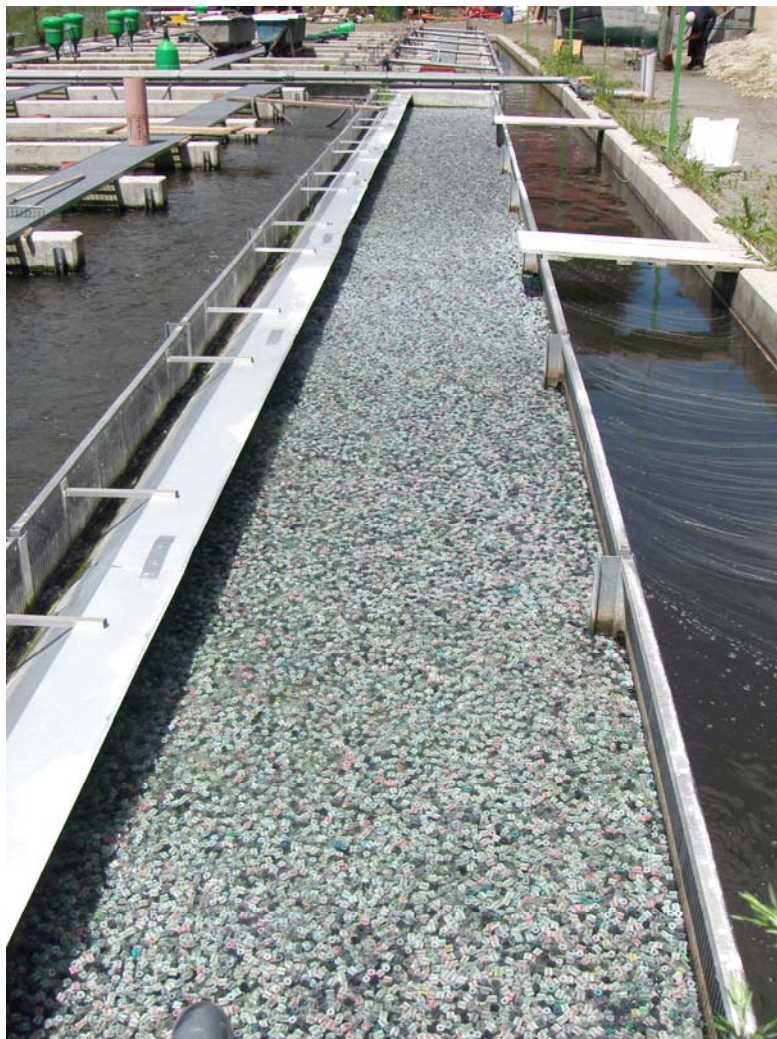
Obr. 5.: Pohled na elementy plovoucího biofiltru.
